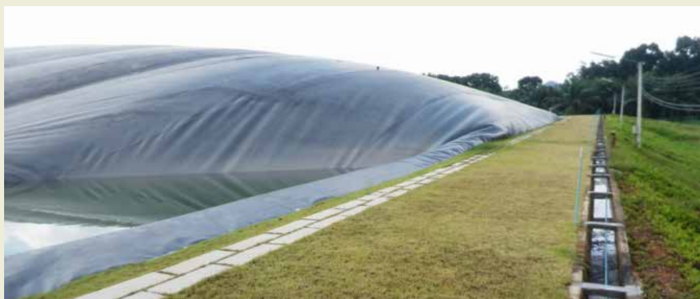
Figura 6: LAGUNA CUBIERTA PARA LA CAPTURA DEL BIOGÁS
